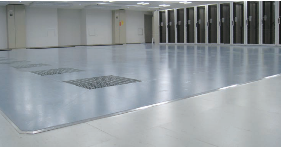
Data Center (Osaka)
